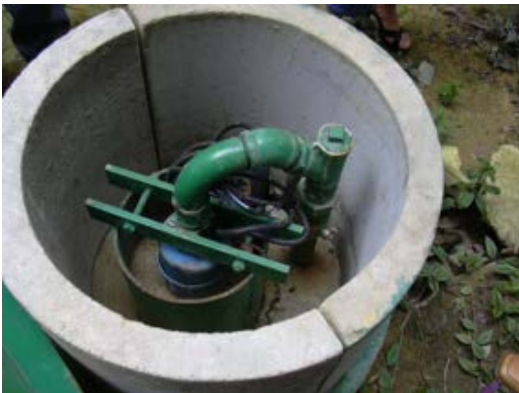
Control de niveles de pozos San Salvador de Bahía, Brasil
