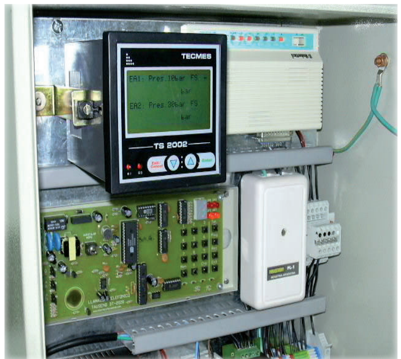
Control de presión en gasoductos, Gas NEA, Entre Ríos, Argentina
