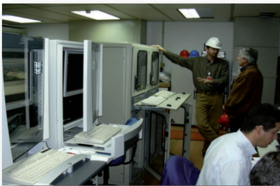
Sala de controle da barragem de ITAIPU
